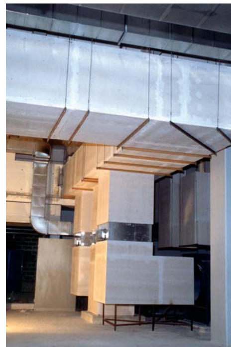
> Conduits coupe feu verticaux et horizontaux - Aérogare D - Roissy
