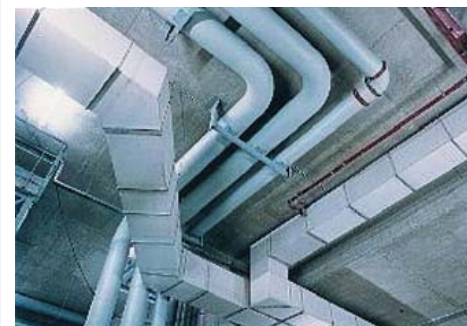
> Conduits de désenfumage coupe-feu 2 heures - Roissy Interconnexion TGV
